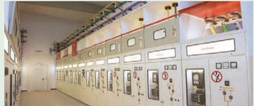
Schaltschränke im Umspannwerk | © RheinEnergie AG
