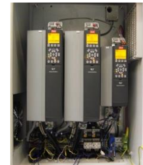
Frequenzumrichter SK1 Fahrantrieb und Tamper
