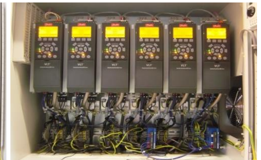
Frequenzumrichter SK3 Kratzerband, Verteilerschnecke Vibration, Hydraulik
